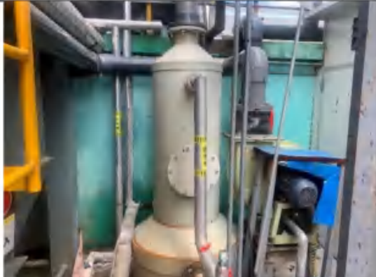
污水处理站一级碱喷淋装置
