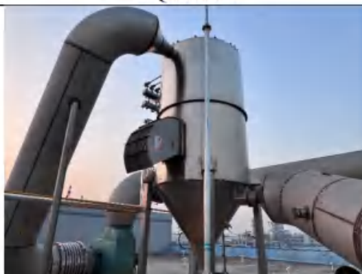
粉体车间末端布袋除尘器 (FQ-509505)
