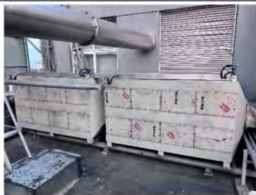
危废仓库二级活性炭吸附装置
