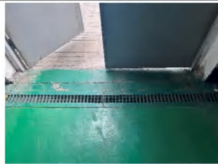
危废仓库内导流沟
