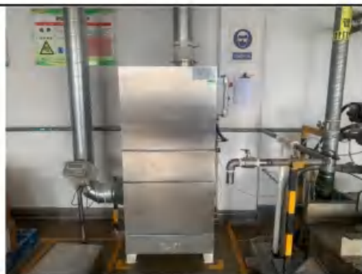
液体车间滤筒除尘器 (FQ-509504)
