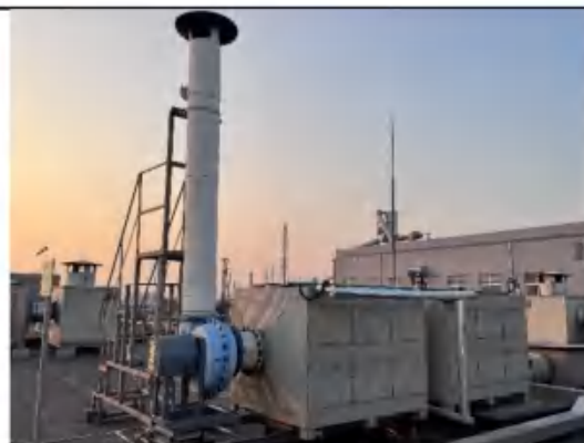
液体车间二级活性炭吸附装置+排气筒 (FQ-509504)
