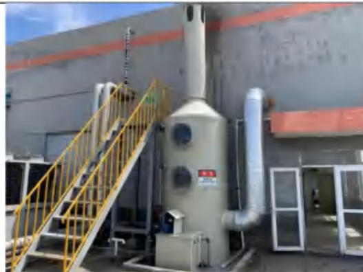
粉体车间水膜除尘器+排气筒 (FQ-509506)
