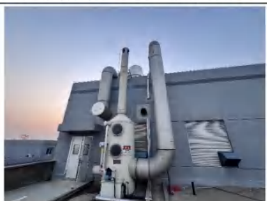
粉体车间水膜除尘器+排气筒 (FQ-509505)
