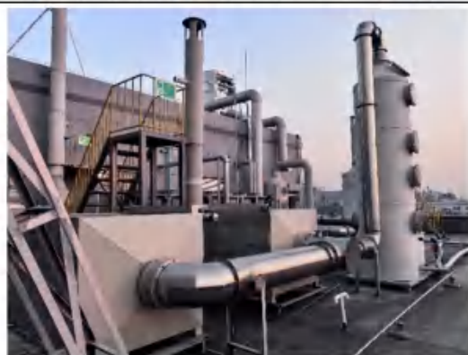
粉体车间二级活性炭吸附装置+水膜除尘器+排气筒 (FQ-509508)
