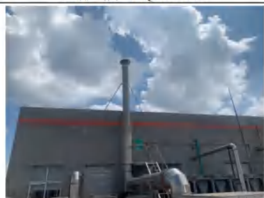
粉体车间排气筒 (FQ-509507)
