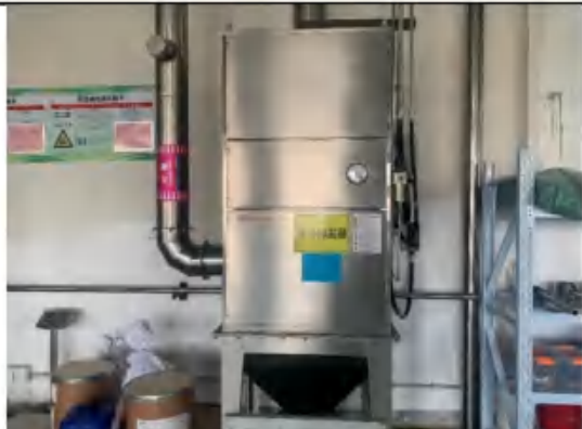
粉体车间滤筒除尘器 (FQ-509508)
