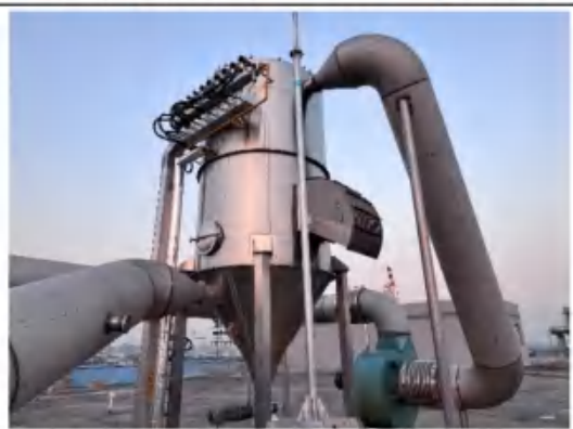
粉体车间末端布袋除尘器 (FQ-509506)
